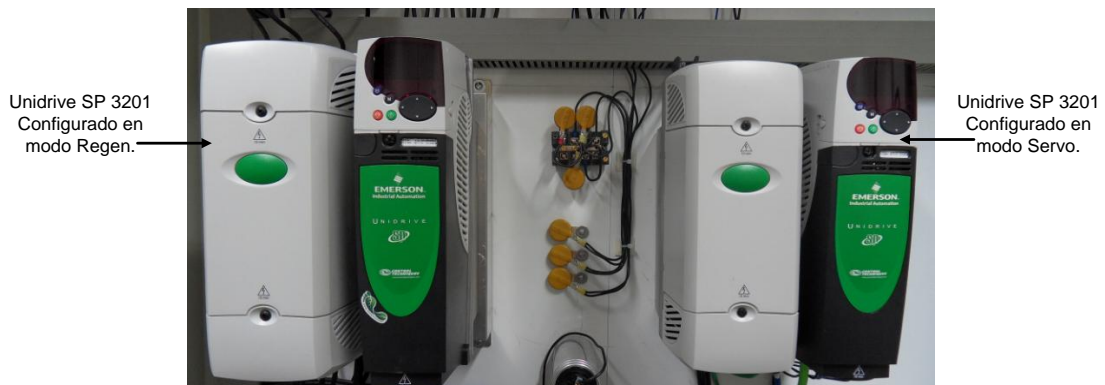
Figura 3. 2 Fotografía de los Unidrive SP 3201 montados en el gabinete.
